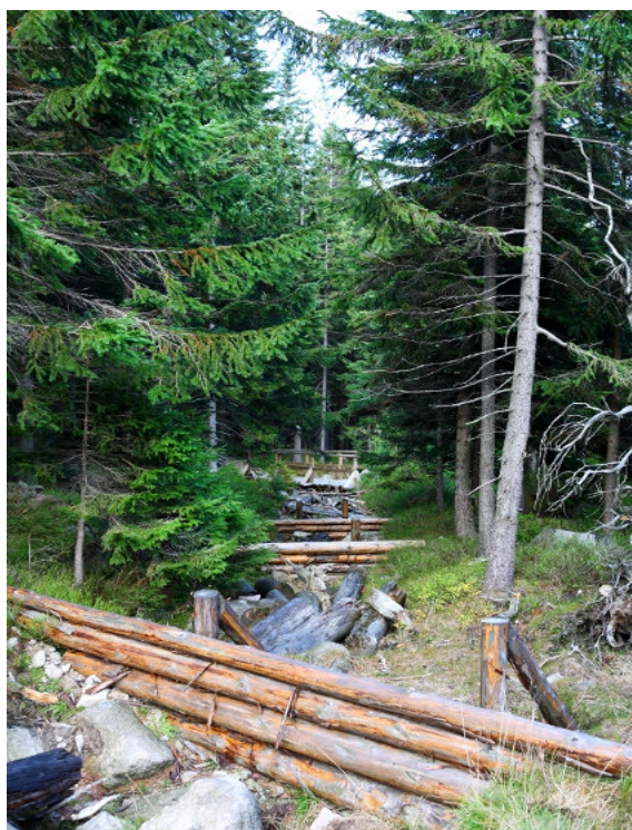
Dawny, zrenaturyzowany szlak zrywkowy zabezpieczony przed spływem powierzchniowym.
